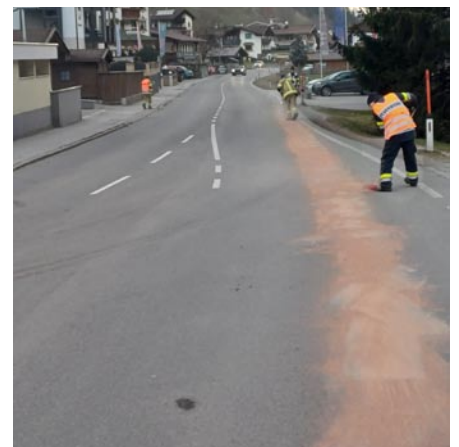
21.11.2024 Ölaustritt, Volderau bis Kampl
